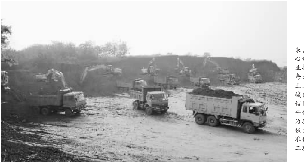
自电子产业园开工建设以来,信阳工业城党委、管委会精心组织,科学施工,B区场平作业推进迅速,三班倒昼夜施工,每天施工18小时以上,已完成土方120万立方米,每日施工机械保持在120余台。10月20日,信阳工业城全面启动了A区场平作业,目前以中环路延长线为界,以南北两个大的作业面强力推进,力争10月底开始标准化厂房的安装建设。图为施工现场。
