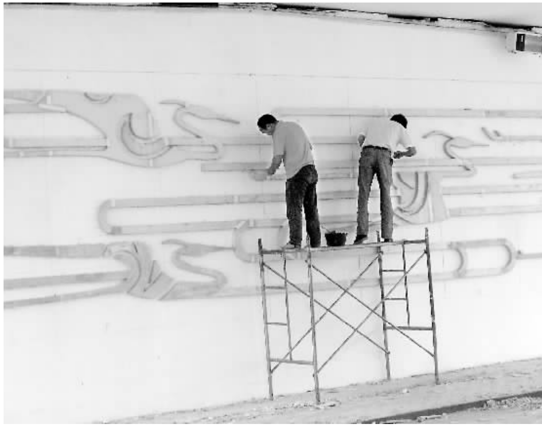
近年来,我市加快旅游兴市的步伐,大力改善城市的建设和人们居住的环境,信阳“桥景”已经成为我市对外宣传的一道亮丽风景线。图为日前施工人员在民桥做桥底彩绘。
