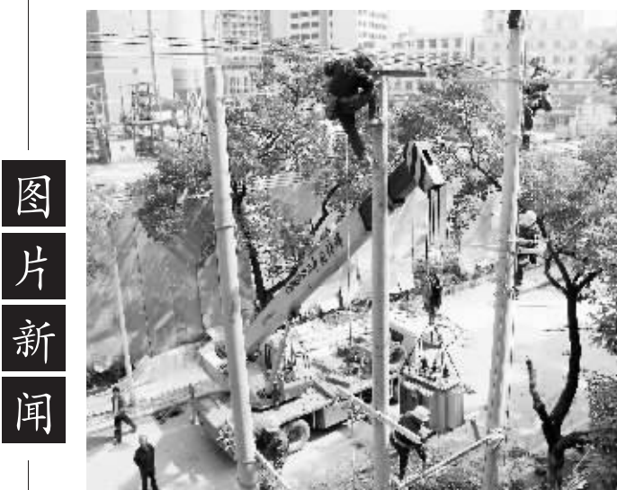
9月30日,信阳供电公司市区礼节路内河沿岸的两台变压器进行移位安装,确保市中心城区内河治理工程的顺利进行和居民可靠用电。 王强 吕玲 摄
