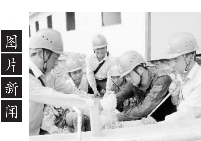
为配合城市建设,信阳供电公司35千伏侯砦线路10号至12号杆之间架空线路改为地理电缆。图为9月1日,该公司施工人员正在配合组装铁塔钢塔架。林平 摄
