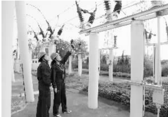
为确保夏季用电高峰期安全可靠供电,淮滨县电业局变电站员工对电力设备进行特殊巡视。图为8月4日,变电站员工对110千伏变电站设备进行测温。王敏 摄
