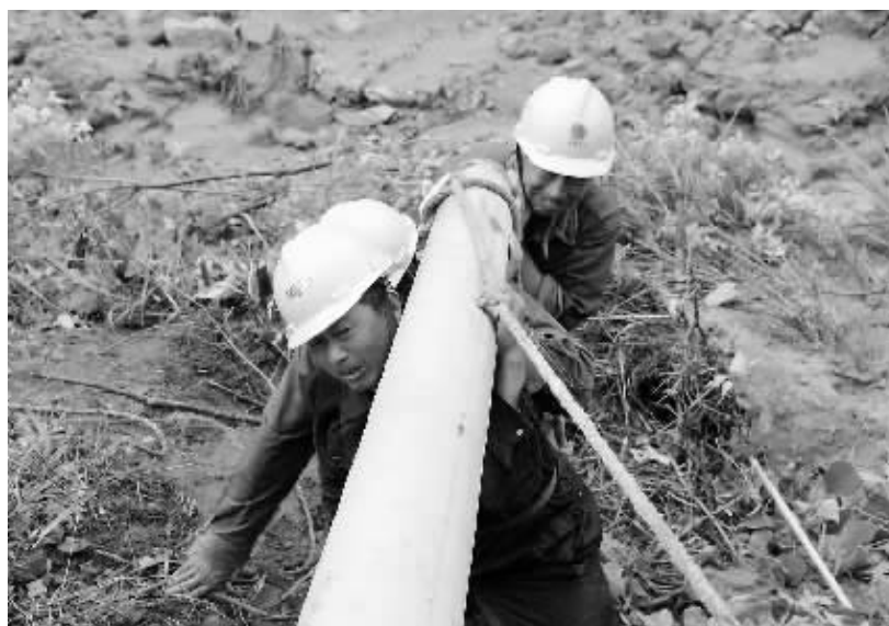
连日的暴雨,引发新县山区多处山体滑坡,电杆倾倒。图为7月21日,新县电业局职工在苏河镇朱店村抬杆杆的情景。陈巍 摄
