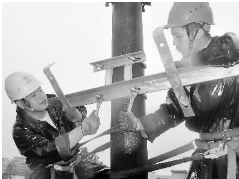
7月16日,平桥区大别山商场一变压器台区发生故障。图为信阳供电公司抢修人员冒雨抢修时的情景。李斌 摄
