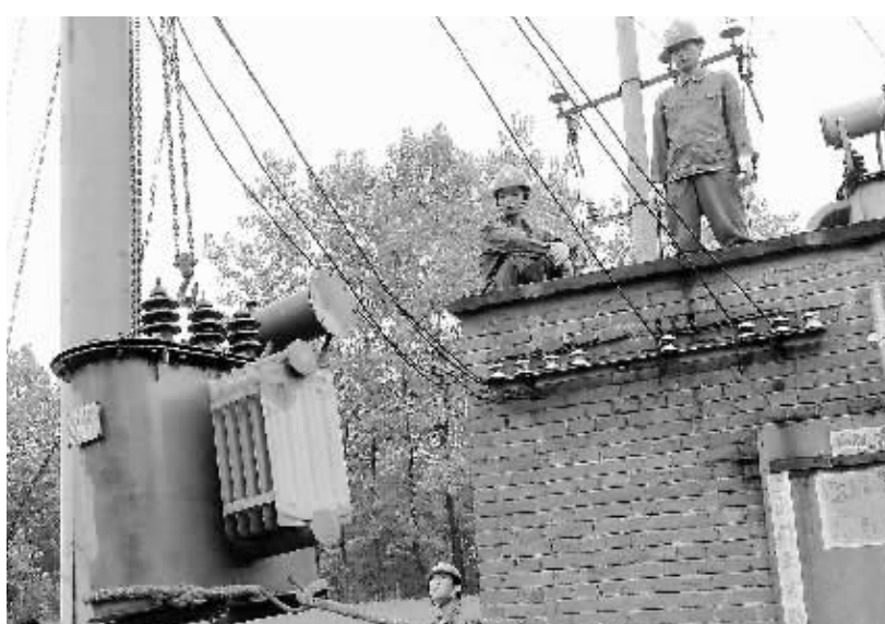
7月22日5时,强降雨引发的山洪造成光山10千伏北6线曹畈支8号杆倒杆断线。图为该县电业局抢修人员正在抢修时的情景。冷军 摄
