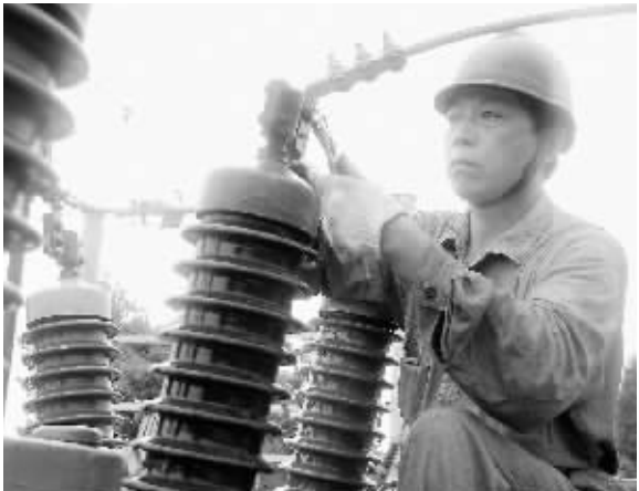
为确保迎峰度夏期间电网安全可靠运行,光山电业局加大对变电设备的检修维护力度。图为7月4日,该局员工对35千伏槐店变电站1号主变进行维护时的情景。 冷军 摄
