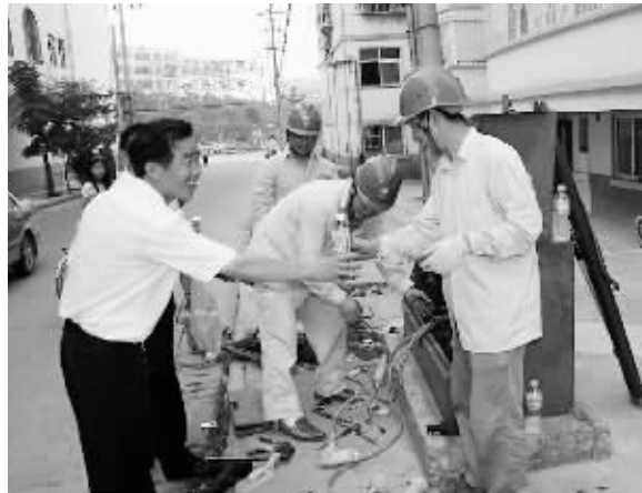
夏日,信阳供电公司抢修人员挥汗如雨,他们的服务受到广大客户的称赞,抢修现场经常出现客户慰问供电抢修人员的动人场面。图为7月6日,客户在翰林园抢修现场慰问抢修人员时的场景。 甘仁伟 冷军 摄
