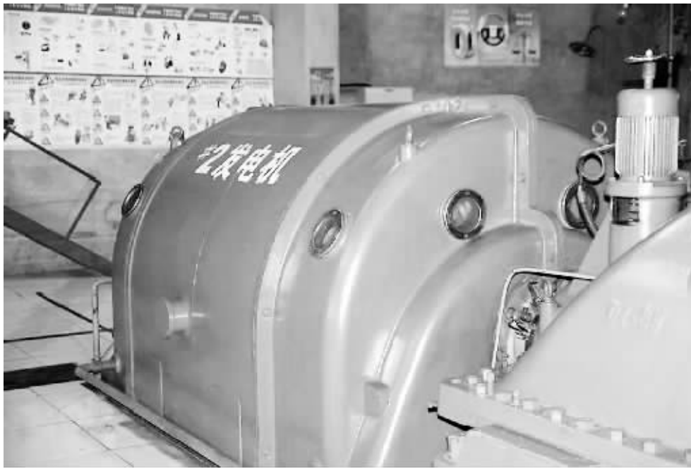
信阳富余煤气发电项目,配套2×6000KW机组。年利用回收煤气发电量10460万KWh,折12850吨标准煤。
