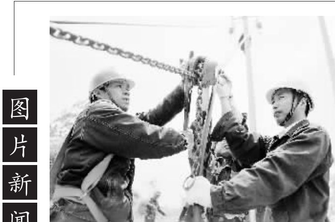
5月14日,信阳供电公司平桥区五里店10千伏工7、11线进行改造,将35千伏十里头变电站承担的负荷转移到110千伏工业变电站上,提高对该区域供电能力。
