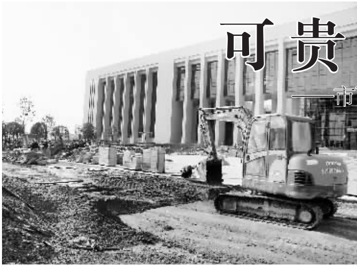
图为施工人员在百花之声门前铺设地板。本报记者 方慧玲 摄
