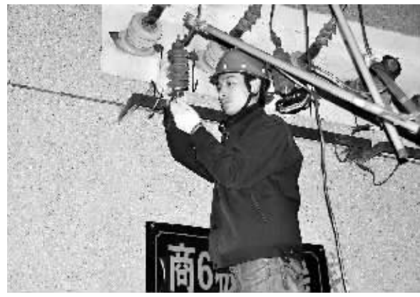
4月10日凌晨5时,商城县供电公司检修工作人员经过近5个小时奋战,顺利完成110千伏商城变电站10千伏I段母线的检修消缺任务。图为检修人员在焊接10千伏出线穿墙套管处松动的接地线。 何莘 摄
