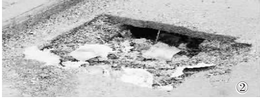
图① 堵塞后马路中间出现的“大水池”。 图② 被垃圾塞满的下水道。
