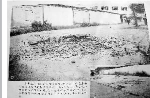
本报曾对市五中道路入口处路面损毁现象进行过报道（见2009年7月24日《信阳日报》六版）。数月过去，记者发现，该路损毁处不但依然如故，而且路边围墙上宣传栏里的健康知识教育内容也不见踪影。“不知道是人为破坏还是相关部门要换新的宣传内容，反正空着已经有两个多月了。”周边居民反映。
